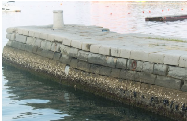
Slika 3: Posedli del pomola na prvi tretjini proti čelu pomola
