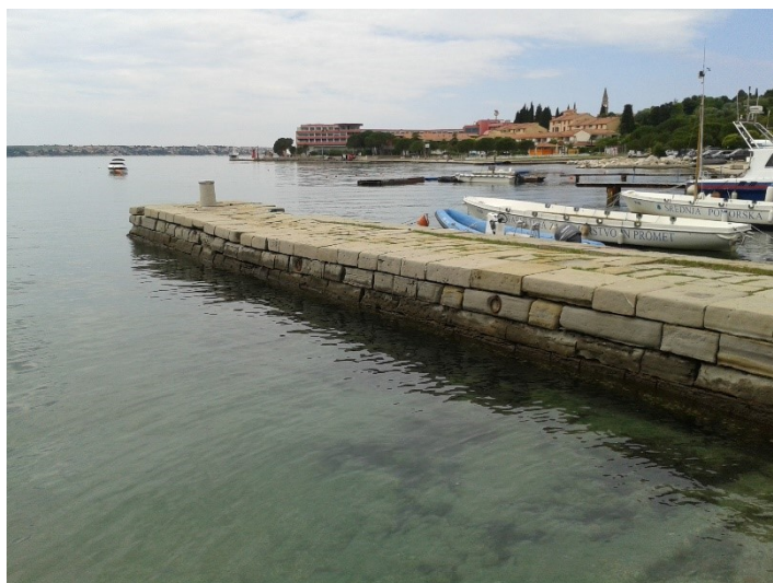
Slika 1: Obstoječi pomol (vzhodno lice)
